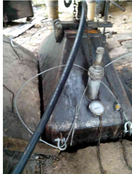
Caldera en hierro en su sitio
